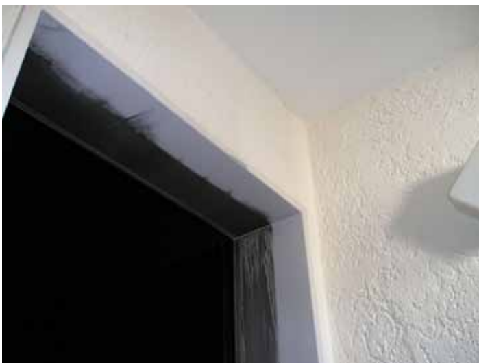
Türzarge nach Ausbau des mobilen Rauchverschlusses nach einem Wohnungsbrand
